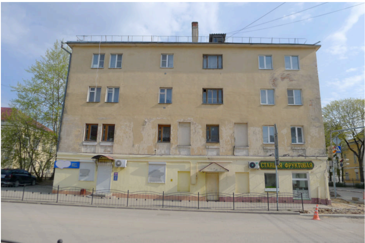
Фото 4. Южный фасад. К первоначальному объему относится стена с 6 осями проемов, включая два заложённых на 2-м этаже.
